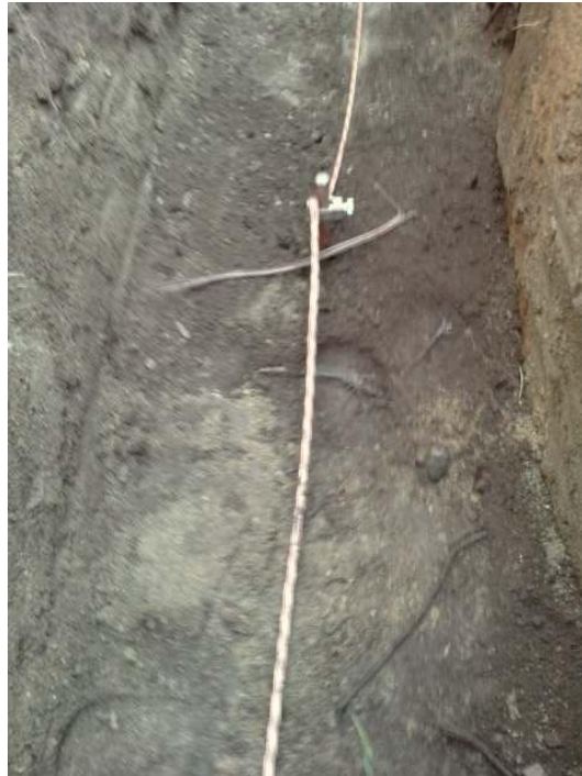
Figura B.4 - Pormenor da ligação do cabo rectilíneo horizontal ao eléctrodo vertical.
