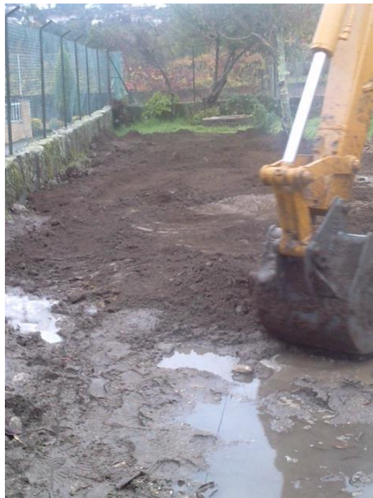
Figura B.5 - Terra de Protecção de um PT: Pormenor de a vala depois de fechada ficar com a terra pouco compactada.
