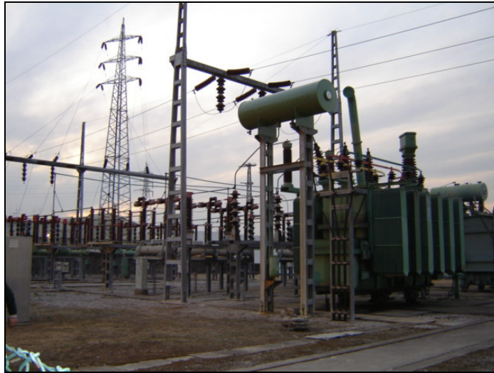
Fig. 19 - Subestação de Braga
