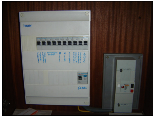
Fig. 10 - Protecções no quadro ( Disjuntor diferencial do lado direito)
