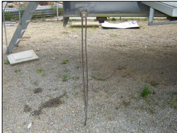
Fig. 25 - Elemento metálico ligado à terra (Lousada)
