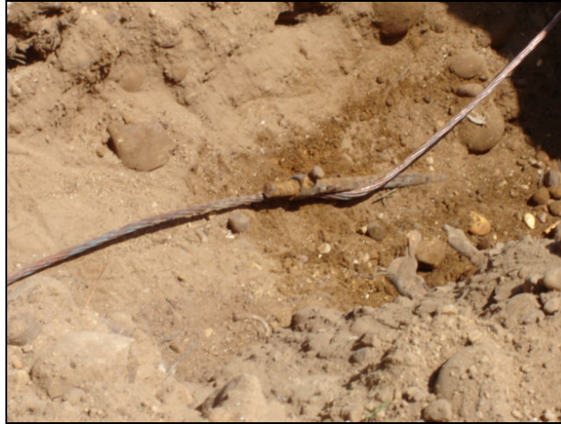
Fig. 56 - Paços: Eléctrodo corroído (note-se a camada de oxido de cor esverdeada)
