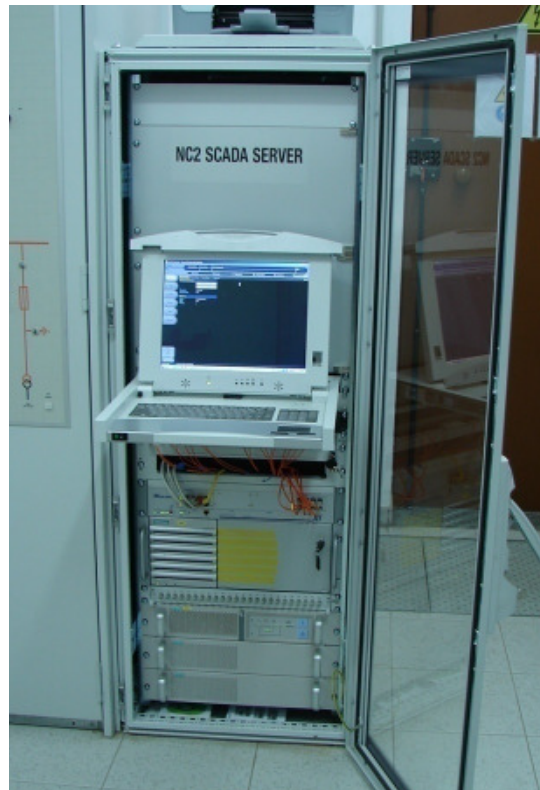
Figura 41 - Controlo remoto dos Aerogeradores instalado numa Subestação
