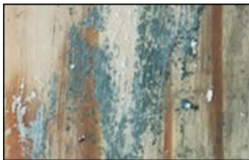
Fig. 4.4 – Elemento de madeira com presença de bolor.
