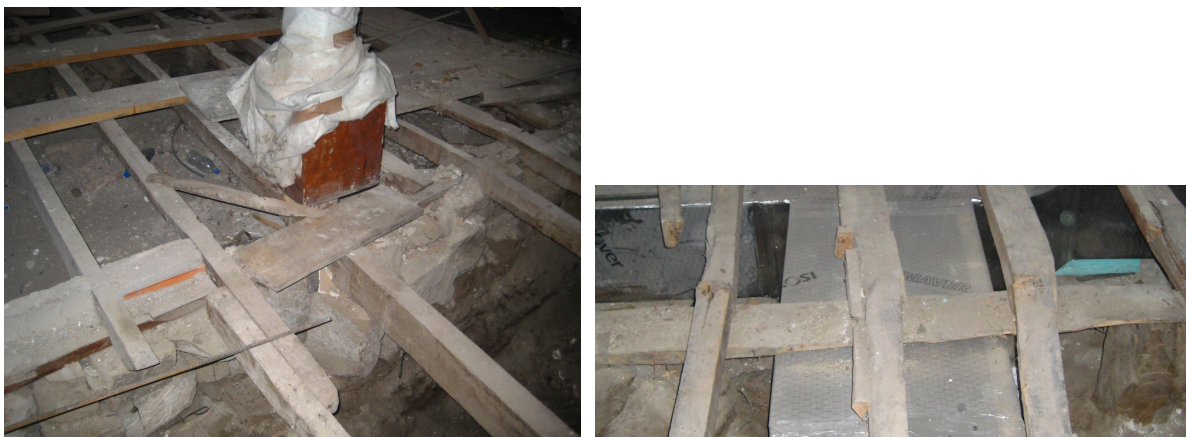
Fig. 6.15 – Pormenor do apoio das vigas em muros de alvenaria de pedra (à esquerda) e alguns problemas de empenamentos e fendas verificados (à direita).
