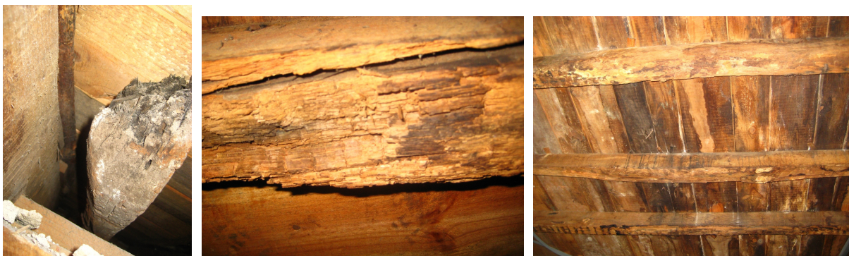
Fig. 6.19 – Algumas patologias encontradas nos vigamentos dos pavimentos dos pisos 1 e 2.
