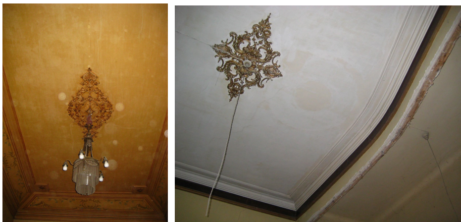
Fig. 6.8 – Tecto em estuque ornamental do hall de entrada (à esquerda) e à direita o tecto do buffet, no qual se verifica também o corte efectuado numa parede divisória em tabique.
