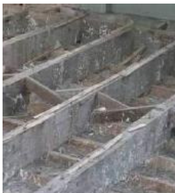
Fig. 2.6 – Tarugamento de cruzeta. Escola Secundária Rodrigues de Freitas, Porto (Costa et al.;2007).
