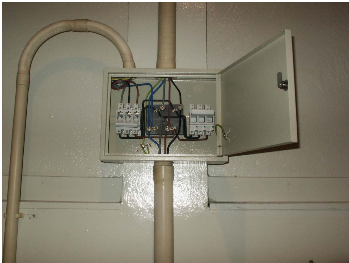
Figura 6c: Instalação Colectiva Didáctica (FEUP): Pormenor de uma Caixa de Colunas.
