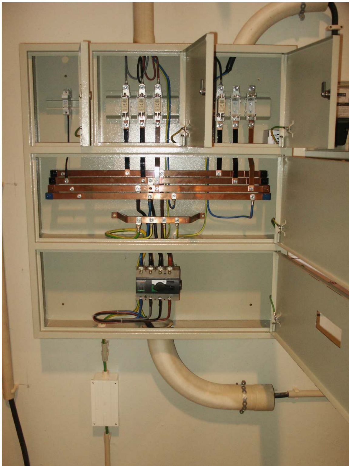
Figura 6b: Instalação Colectiva Didáctica (FEUP): Pormenor do Quadro de Colunas.
