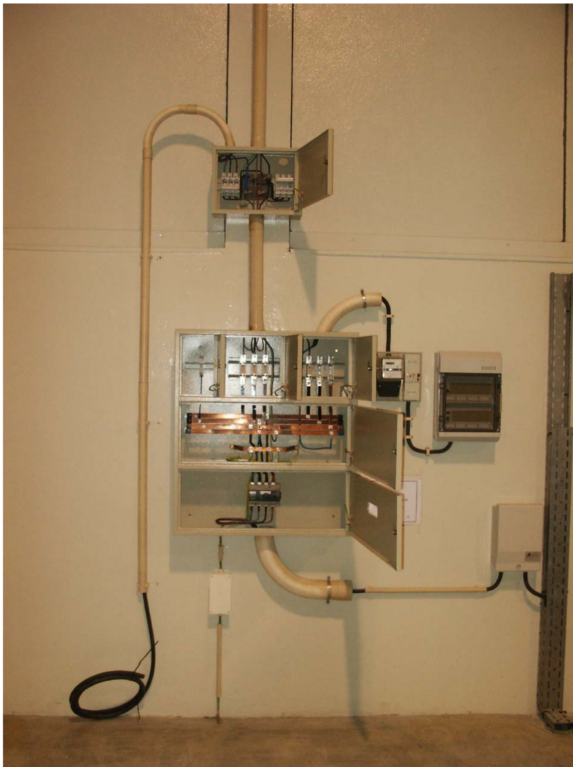
Figura 6a: Instalação Colectiva Didáctica (FEUP): Vista Geral.
