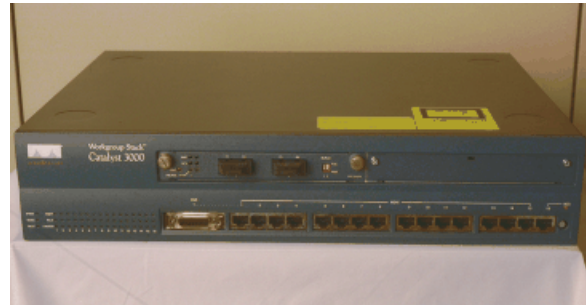
Comutador de tramas ( switch )
