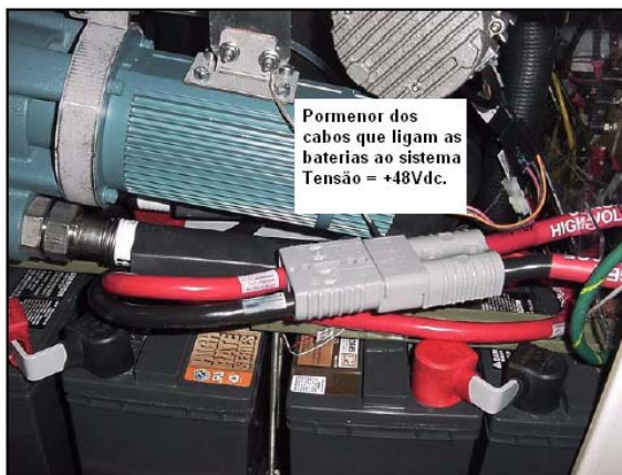
Figura 7 – Baterias e respectivas ligações através de ficha “Anderson”. Fonte: Plug Power.
