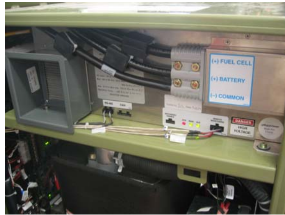
Figura 8 – Conversores DC/DC principal e auxiliar. Fonte: Plug Power.
