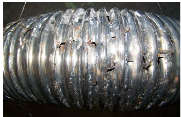
Figura 3. Tipología de las fisuras de la manguera metálica interior
