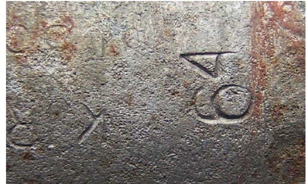
Figura 8. Picaduras encontradas en la superficie exterior del tubo.
