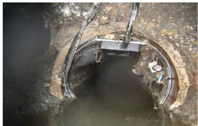
Figura 3. Medidor de caudal instalado na caixa n.º 62.
