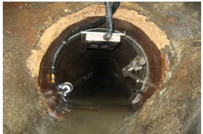
Figura 2. Medidor de caudal instalado na tubagem de entrada da caixa de visita n.º 12.
