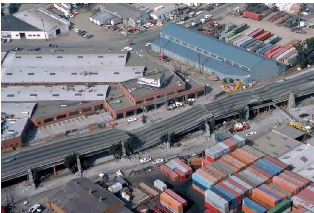
Figura 5.7 Vista aérea das secções que abateram no viaduto Cypress da auto-estrada interestadual 880 provocadas pelo terramoto de 1989 5 .
