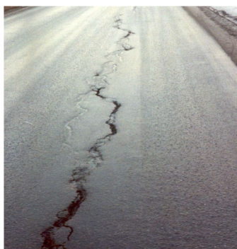
Fig. 2 -Estrada fendilhada [Watn e Hoff, 2010]
