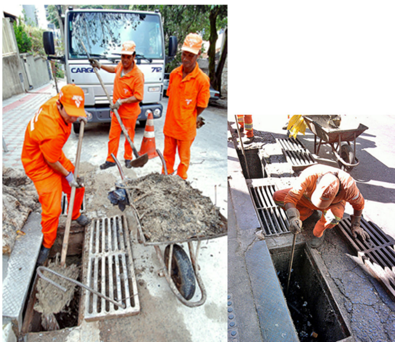
Fig. 1 - Retirada de entulho e lixo em bocas de lobo de Belo Horizonte Fonte: http://portalpbh.pbh.gov.br/pbh
