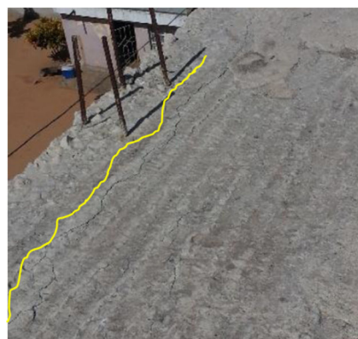
Fissura no alinhamento do apoio da laje
