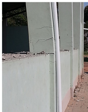
a) Fendas nos pilares
