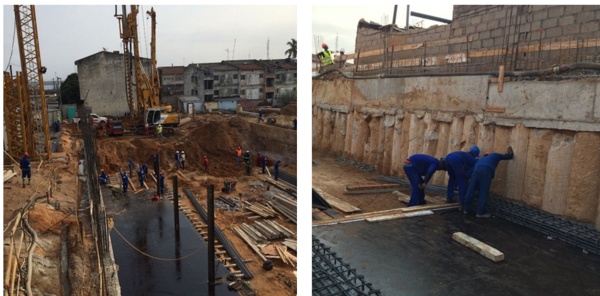
Fig. 2 - Imagens da Fase de Escavação do Edifício B e montagem da armadura da banda de laje.
