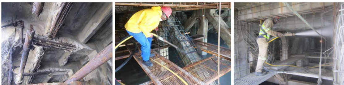
Fig. 2 - Vigas com armadura exposta. / Solução de reabilitação e reforço através de betão projectado.
