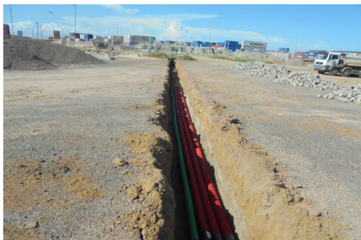
Fig. 6 - Instalação de condutas que irão permitir a distribuição da rede de cabos eléctricos e de dados
