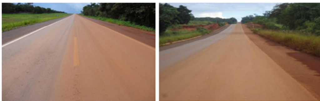
Fig. 4 - Condições do pavimento no Km 13,00 e Km 72,20 respectivamente.
