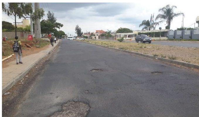
Fig. 2 - Buracos na camada de pavimento
