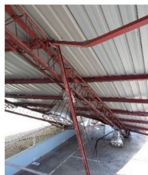
c) Corrosão generalizada da estrutura metálica
