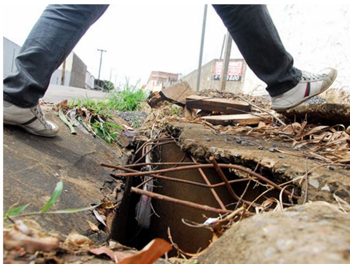
Fig.2 - Boca de lobo sem grelha - perigo aos transeuntes Fonte: www.folhadaregiao.com.br
