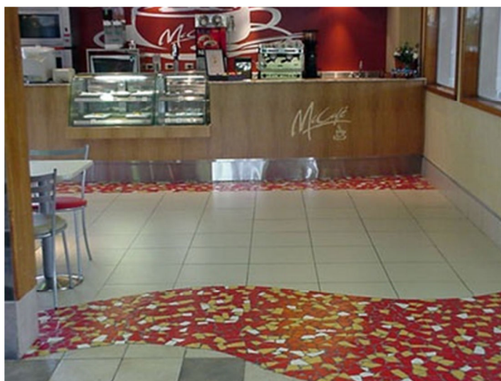
Fig. 15 - Placas quebradas (dicasdaarquiteta.ig.com.br )
