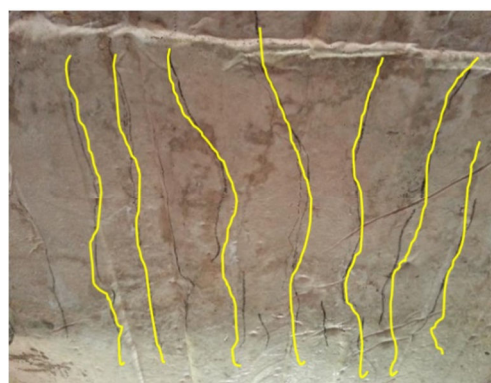
Fissuração nas lajes vista pela face inferior.
