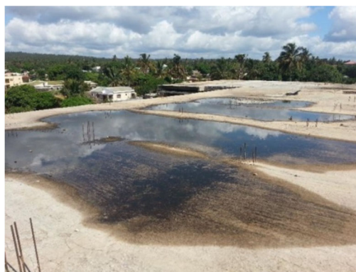
Deformação visível na laje do piso do terraço.
