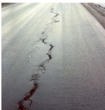
Fig. 2 -Estrada fendilhada [Watn e Hoff, 2010]
