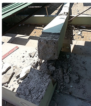
b) Rotura do pilar
