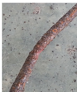
d) Perda de secção dos tirantes por corrosão
