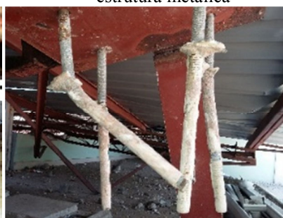
f) Arrancamento total dos chumbadores
