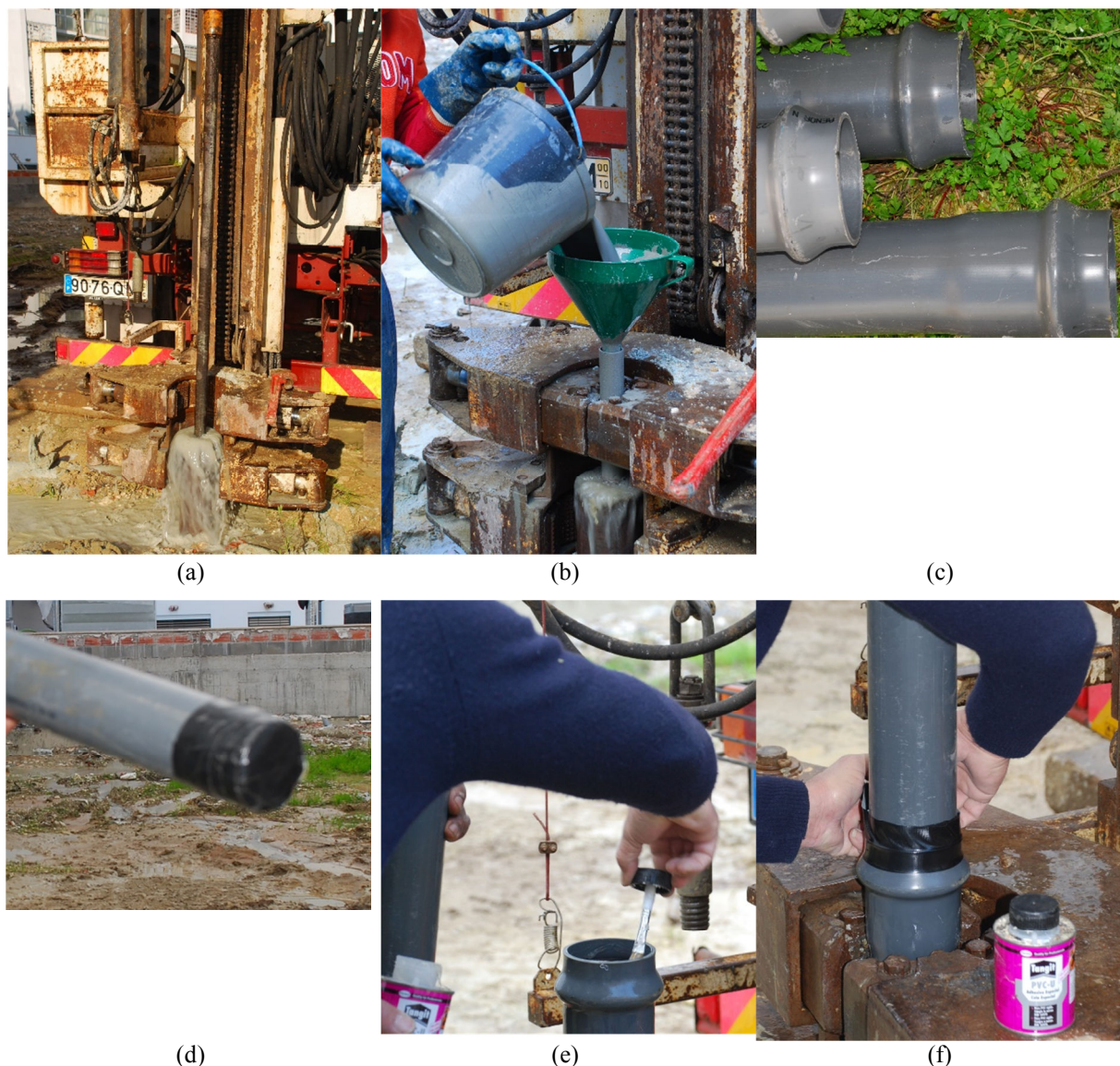
Fig. 5 - Montagem dos tubos de PVC para ensaios sísmicos no campo experimental: (a) aspeto geral da furação; (b) colocação da calda de cimento; (c) tubos com ligações UNI; (d) base do tubo obturada; (e) colocação de cola nas uniões entre trechos; (f) proteção das uniões com fita adesiva de alta resistência.
