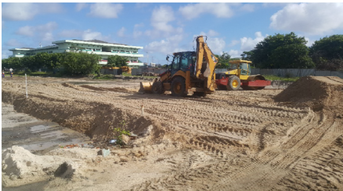
Fig. 24 - Aterro com uma camada de areia de 500mm de espessura e compactação dos solos
