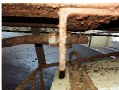
e) Corrosão das ancoragens dos tirantes
