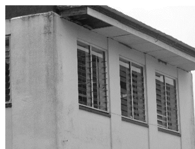
Edifício unifamiliar - venezianas reguláveis nas aberturas para controlar o fluxo de ar
