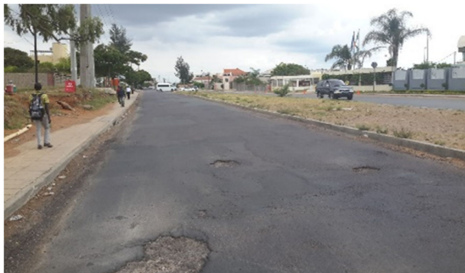
Fig. 2 - Buracos na camada de pavimento
