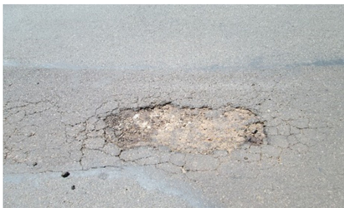
Fig. 3 - Ilustram a fissuração e o conseqüente surgimento de buracos.
