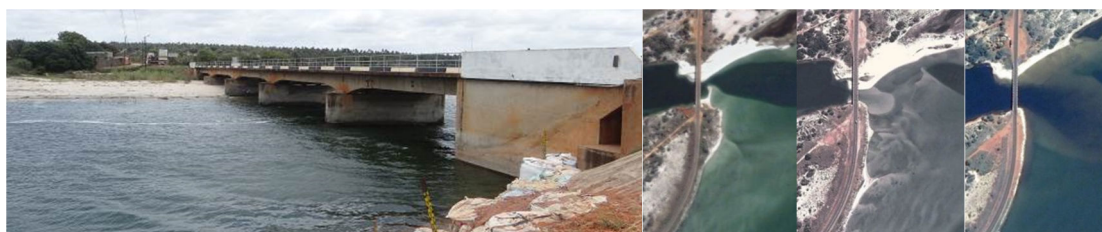
Fig. 1 - Vista da ponte de Inharrime antes da intervenção e vistas aéreas da evolução da erosão nos anos de 2004, 2011 e 2013.
