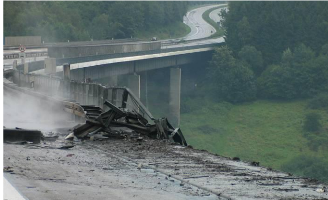
Figura 2 – Colapso de barreira metálica após impacto.
