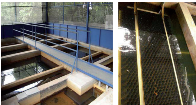
Figura 11.4. Vista del área de sedimentadores y de las lamelas instaladas en dicha unidad en la planta Río Azul de tratamiento (Mixco, Guatemala).
