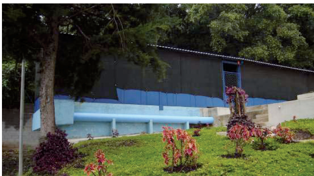
Figura 11.6. Vista frontal de la planta de tratamiento de remoción de arsénico Río Azul.
