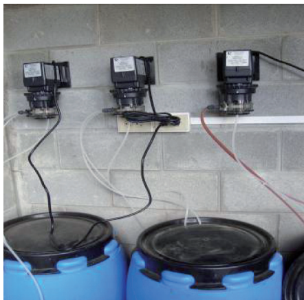
Figura 11.3. Vista del sistema de dosificación de reactivos químicos.
