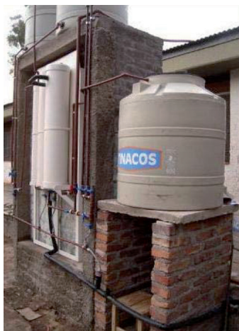
Figura 13.9. Planta instalada en la escuela de San José.
