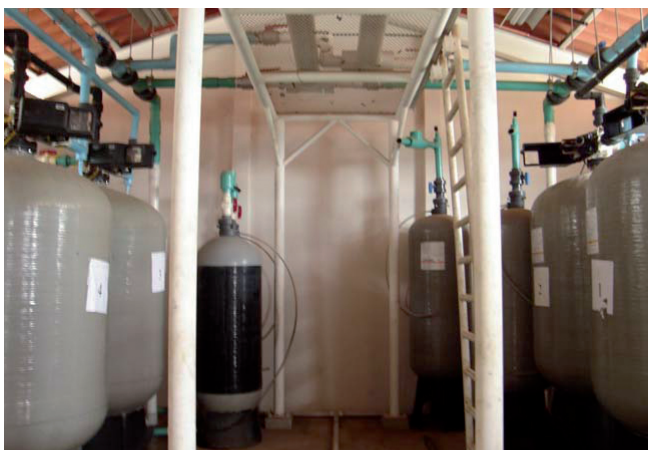
Figura 11.5. Vista del sistema de filtración de la planta Río Azul de tratamiento (Mixco, Guatemala).
