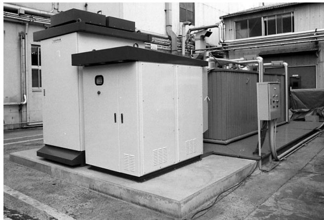
Figura 2.12 – Ilustração de aplicação de VRB no exterior com 50kW [30].
