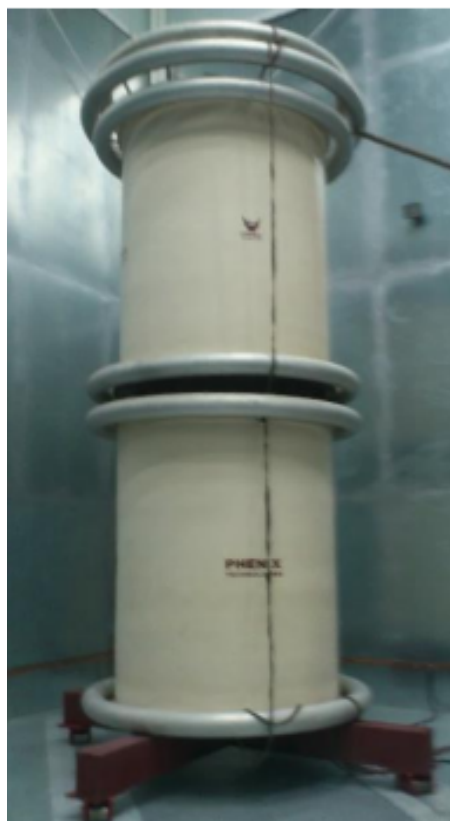
Figura 4.6: Transformador existente no LAT
