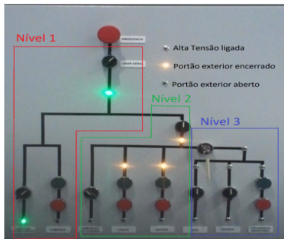
Figura 4.5: Quadro de comando
