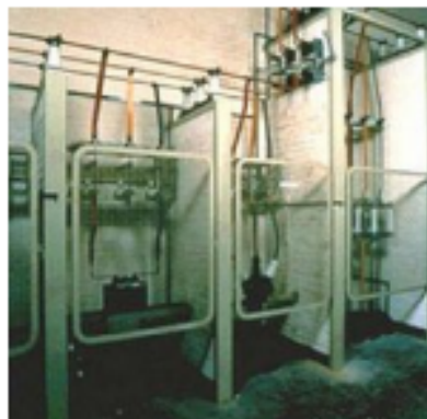
Figura 3.4: Cúbico com disjuntores com isolamento a ar. [9]
