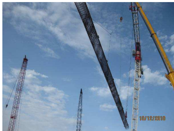
Fig. 5.4 – Levantamento da armadura de uma estaca, tarefa realizada com duas guias em simultâneo.
