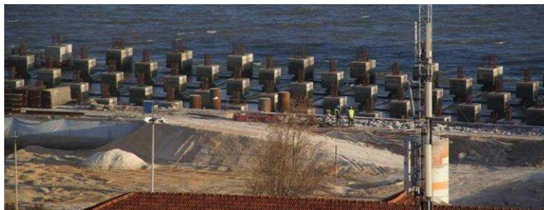
Fig. 2.64 – Cais acostável em estacas de betão armado construído parcialmente desde plataforma terrestre [62].
