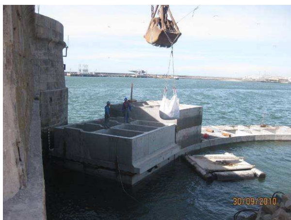
Fig. 3.126 – Início da sobrecarga nas aduelas.
