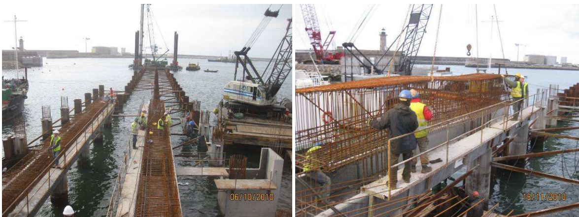
Fig. 4.19 – Exemplo de recurso a guarda corpos nas operações de colocação de armaduras na obra exemplo.
